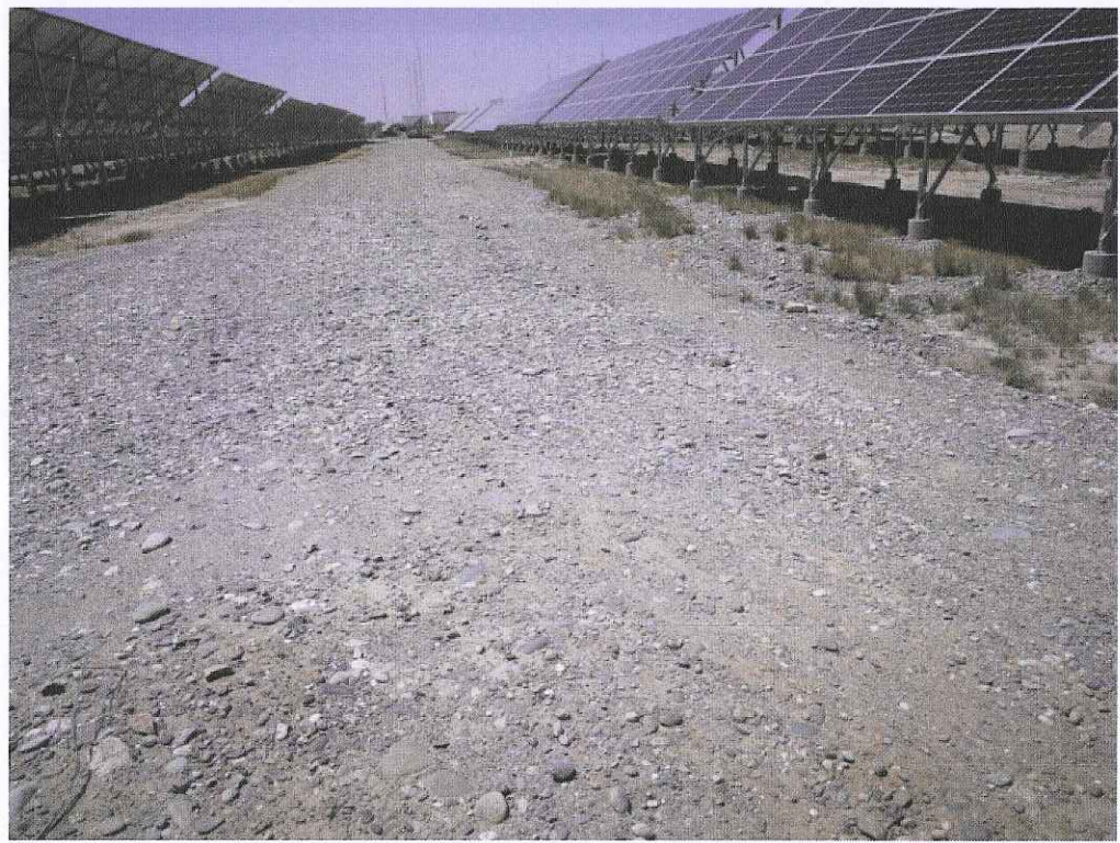
光伏场现状照片
