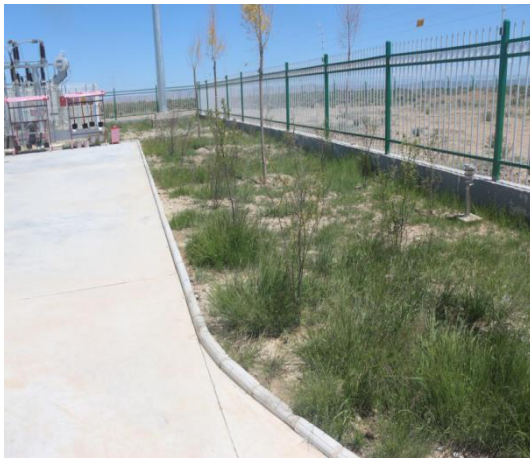
35kV 开关站植被恢复现状
