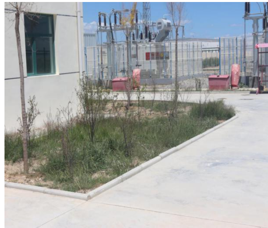
35kV 开关站植被恢复现状
