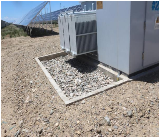
逆变器配套的事故油收集槽
