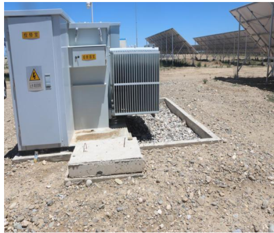
每台逆变器均配套有事故油池
